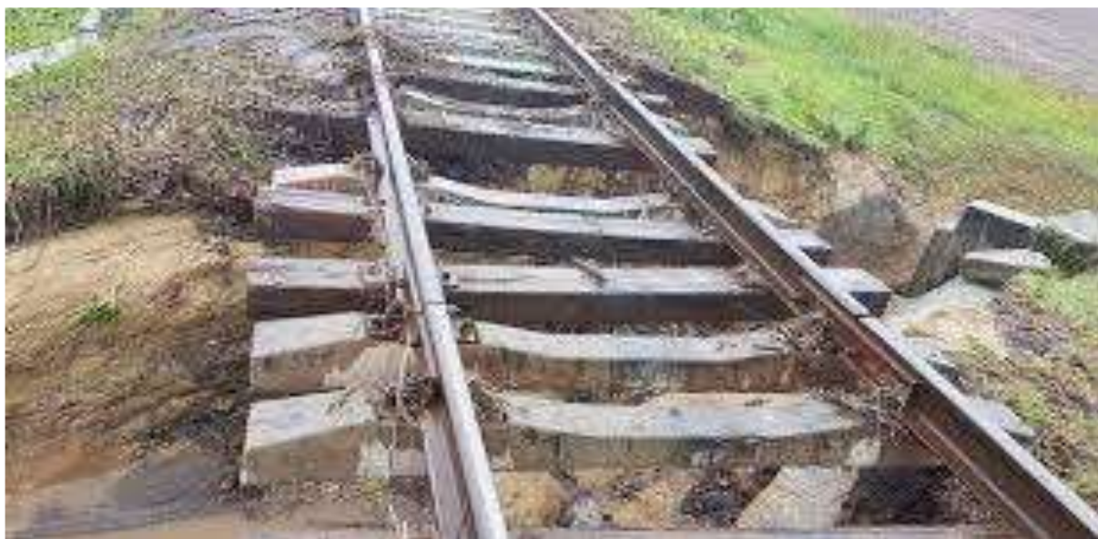
Рис.1. Последствия оползны на железную дорогу.
