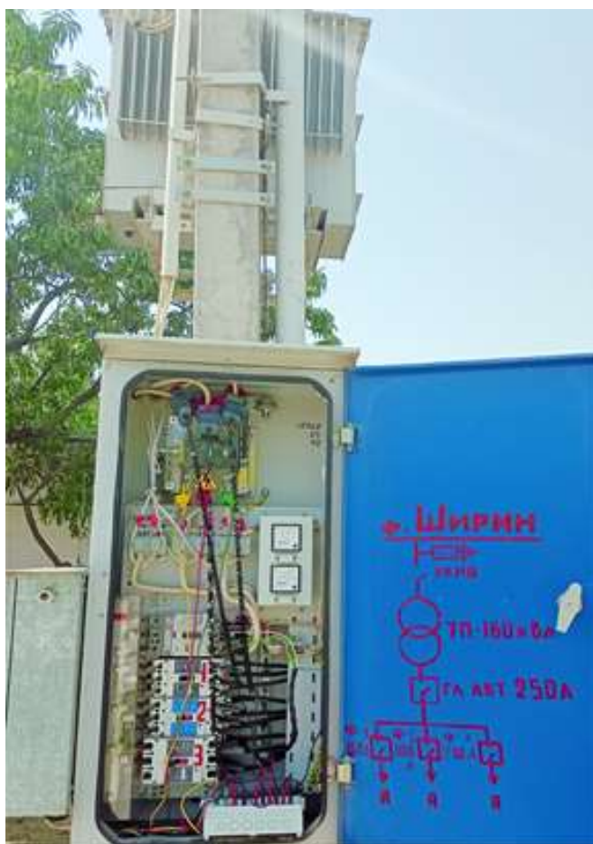
2-rasm. Tadqiqot ob'ektidagi transformator punkti.
