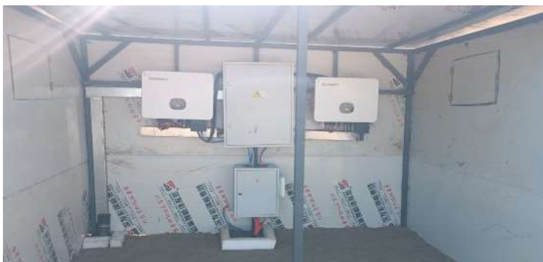
2-rasm. Farg'ona viloyatida joylashgan nasos stansiyasini ta'minlash uchun o'rnatilgan 100kW quvvatga ega quyosh fotoelektrik stansiya.
