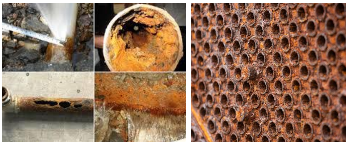
3-rasm. Qurilma metall qismlarida korroziyaning ko‘rinishlari.
