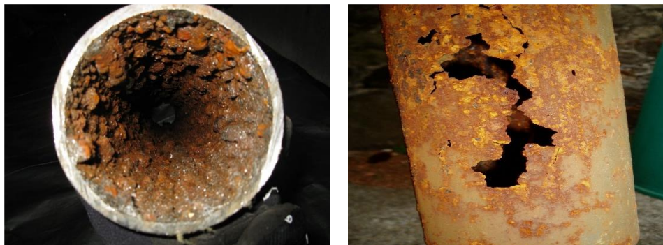
3-rasm Quvrlarning korroziyaga uchrashi.
