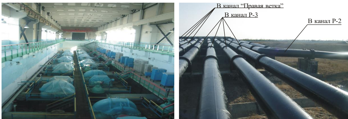
Рис.1. Машинный зал и напорные трубопроводы НС «Арнасай».
